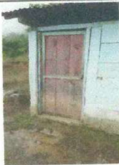
Foto 3: SE NECESITA SUSTITUCIÓN DE PUERTAS DEL MODULO 1
