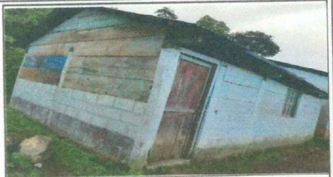
Foto 2: SE NECESITA SUSTITUCIÓN DE PAREDES
