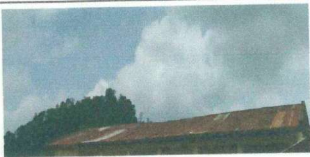
Foto 5: SE OBSERVA EL DETERIORO DEL LAMINAS DEL ESTABLECIMIENTO
