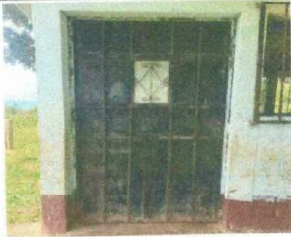
Foto 1: SE NECESITA SUSTITUCIÓN DE PUERTAS
